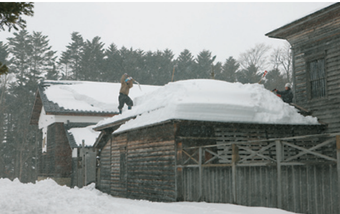
連日の雪のため、あちこちらの建物で屋根の雪下ろし作業が行われていました
